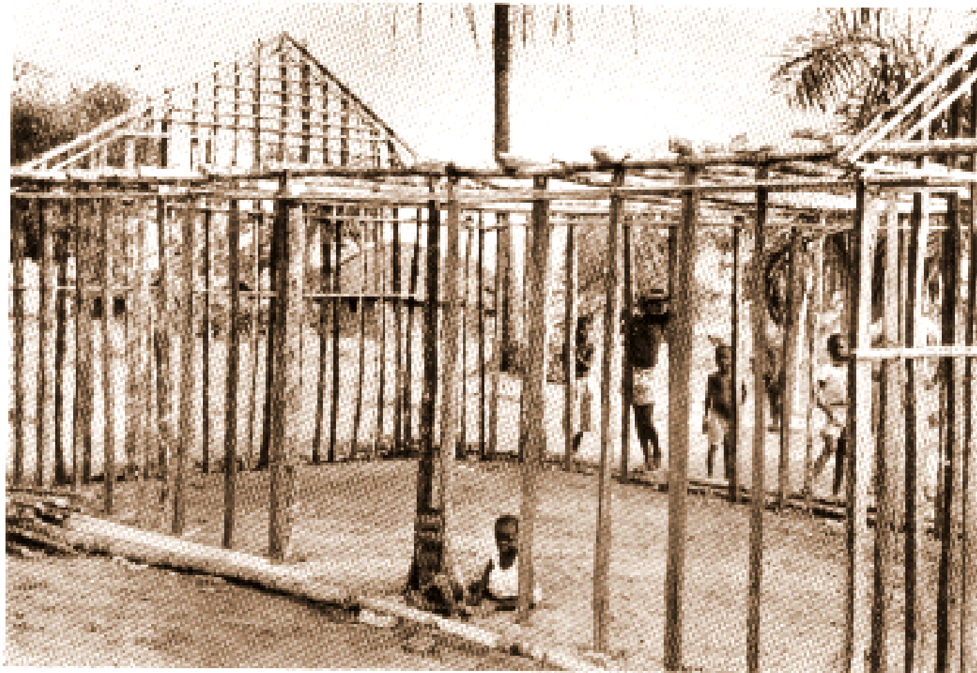
2. Construction d'une maison. On commence par monter la charpente en bois. Le toit sera couvert de paille. Les murs seront remplis de terre mélangée à de l'argile pour l'habitation principale et recouvert de paille pour les annexes.
